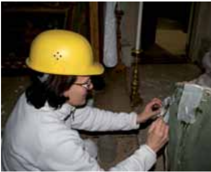
9 Fig. 9 - È frequente la necessità di un pronto intervento immediato.
